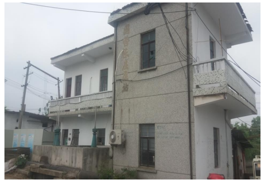
图 3-7 现状东庄泵站
