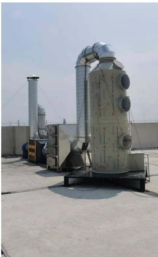
图 3-1 项目水喷淋+活性炭吸附装置
