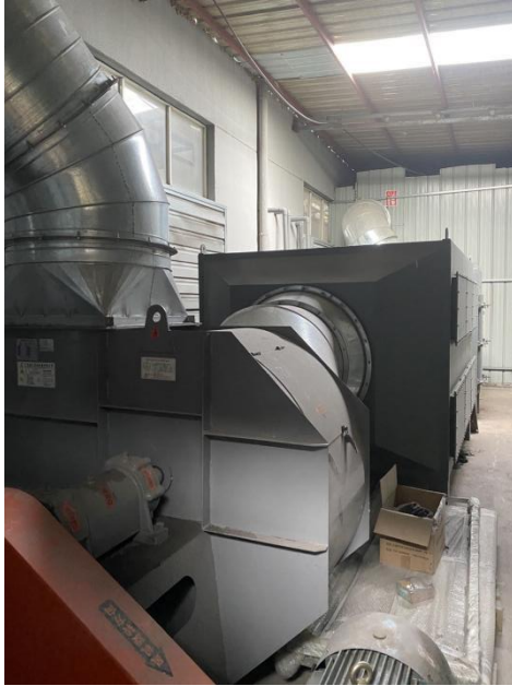
图 3-1 项目二级活性炭吸附装置
