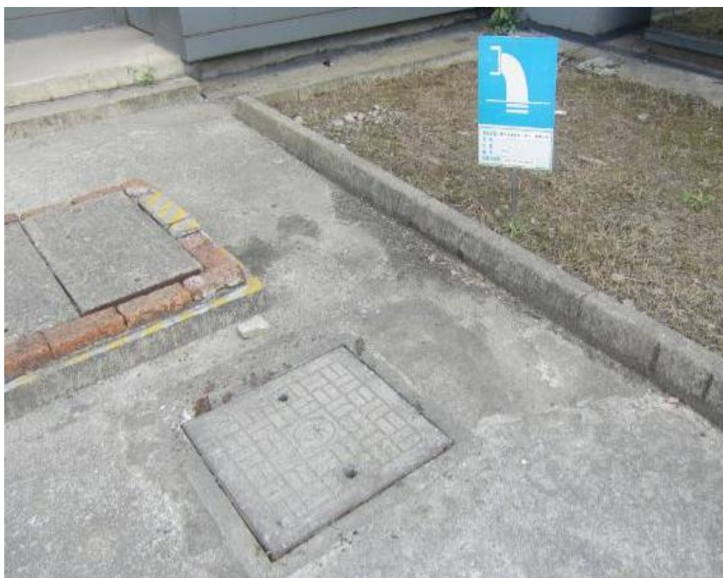
生活污水排口
