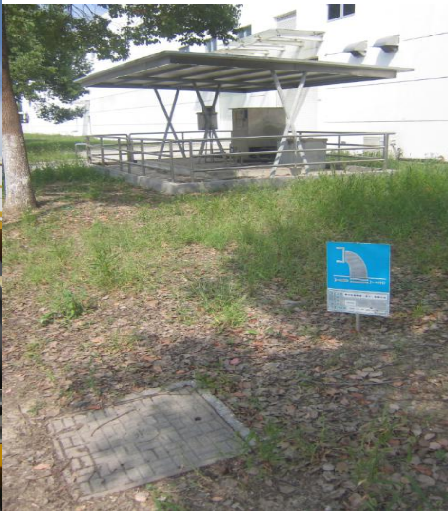
生产废水排口
