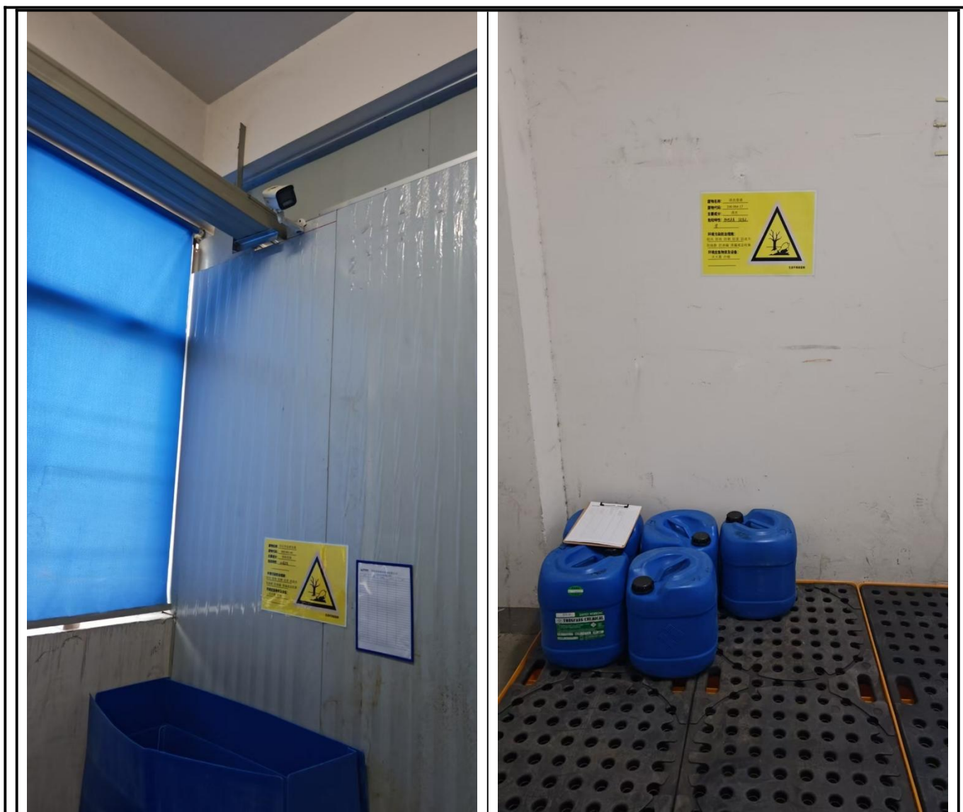
图 3-3 危险废物仓库
