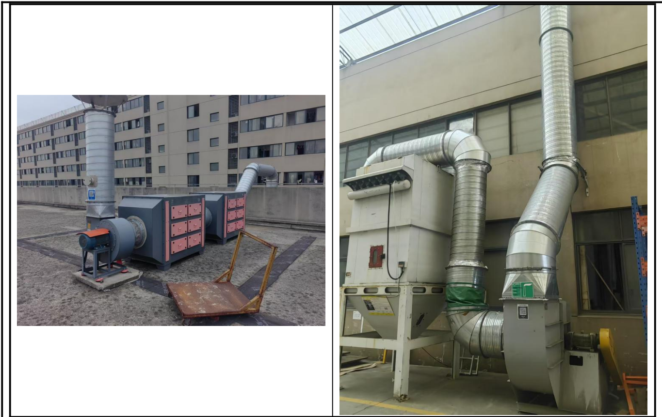
图 3-2 现场废气治理措施照片
