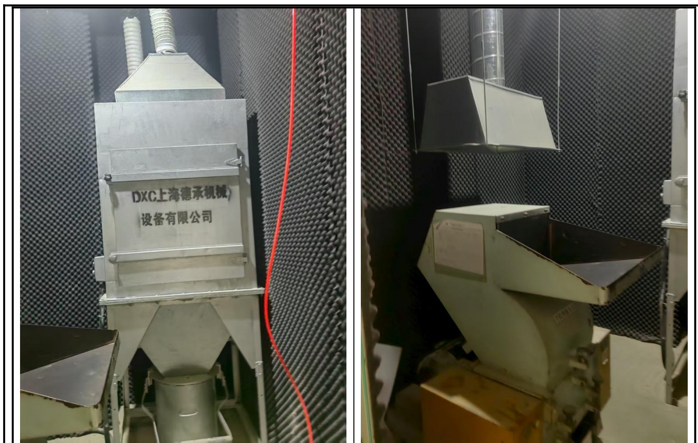
图 3-2 现场废气治理措施照片
