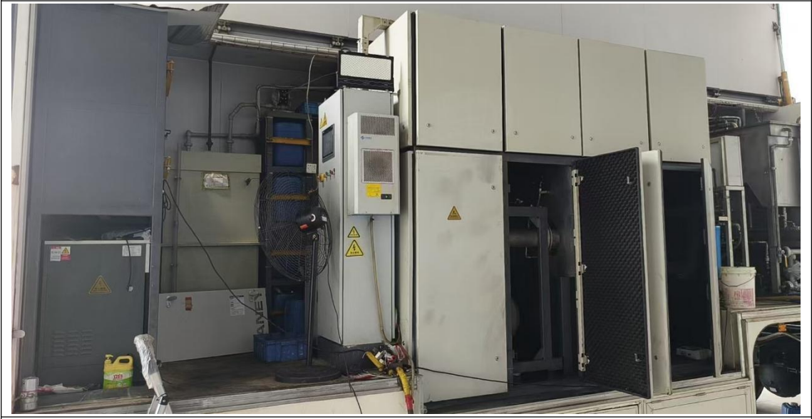
3t/d 污水处理设施
