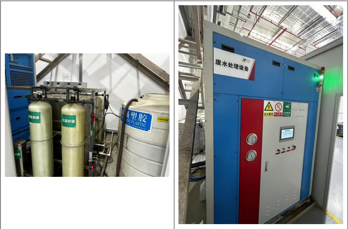
5t/d 污水处理设施
