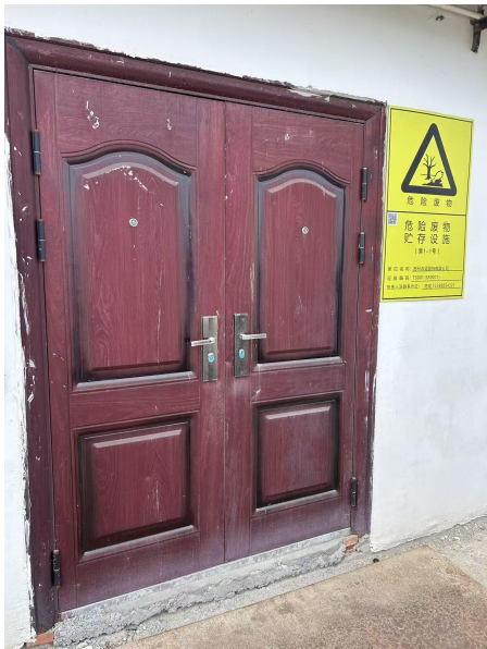
危废暂存间正门及贮存设施标志牌
