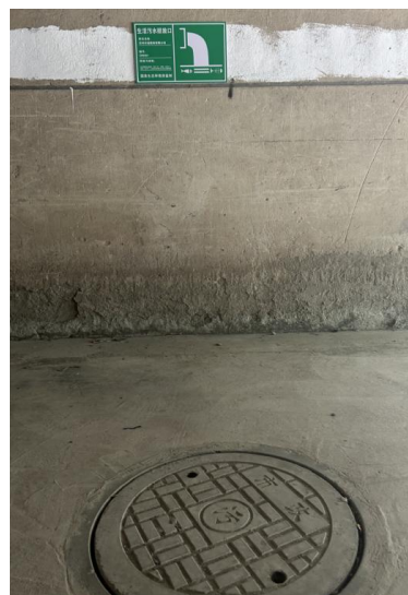
生活污水排放口
