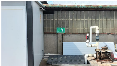
生产废水排放口
