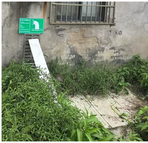
生活污水排放口
