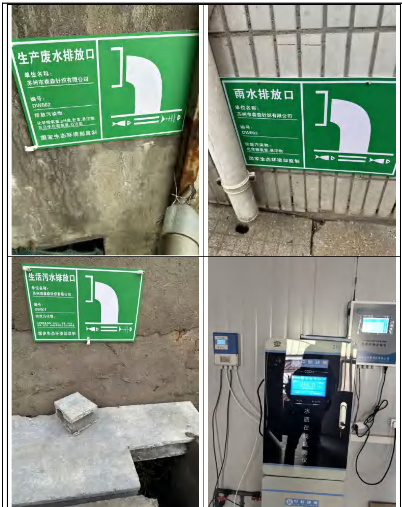
图 3-3 雨污排口标识、在线装置
