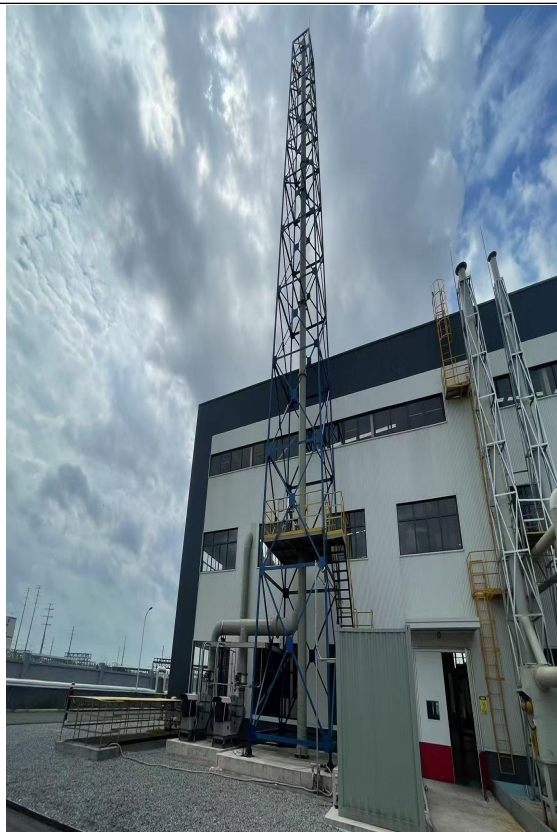
FQ-06 排气筒 35 米 (DA004)
