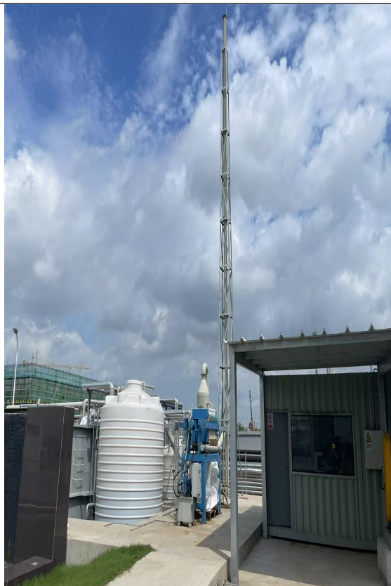
FQ-11 排气筒 15 米 (DA009)
