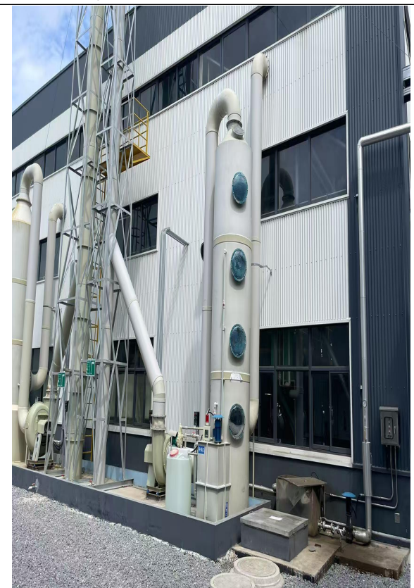
FQ-02 处理设施 (三级酸洗塔)
