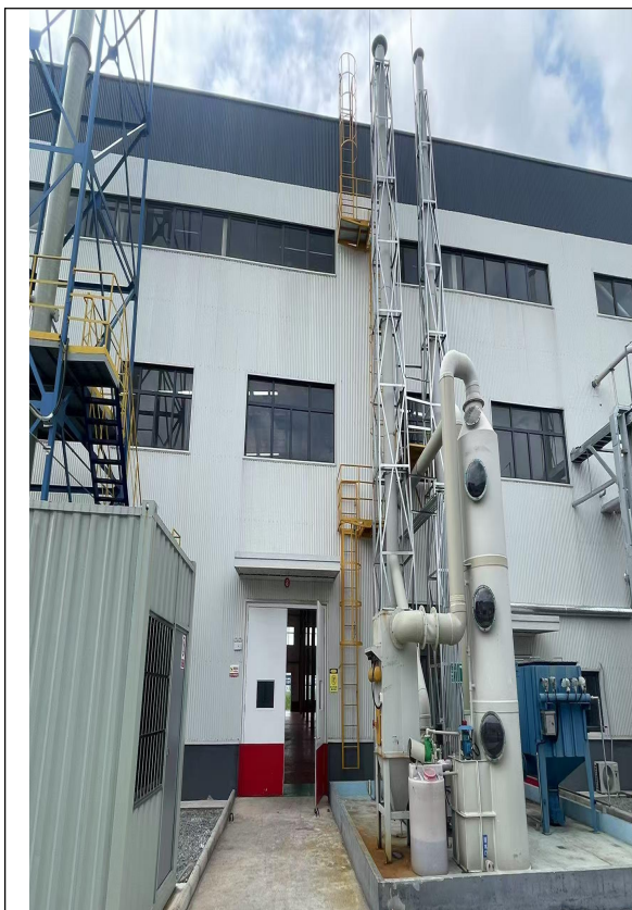
FQ-07 排气筒 15 米 (DA005)
