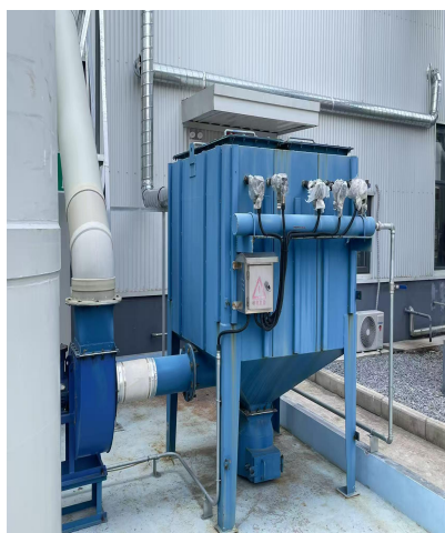
FQ-04 处理设施 (活性炭、布袋除尘)
