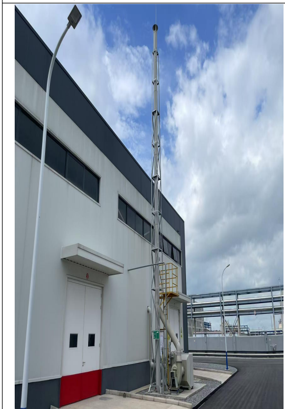
FQ-08 排气筒 15 米 (DA010)
