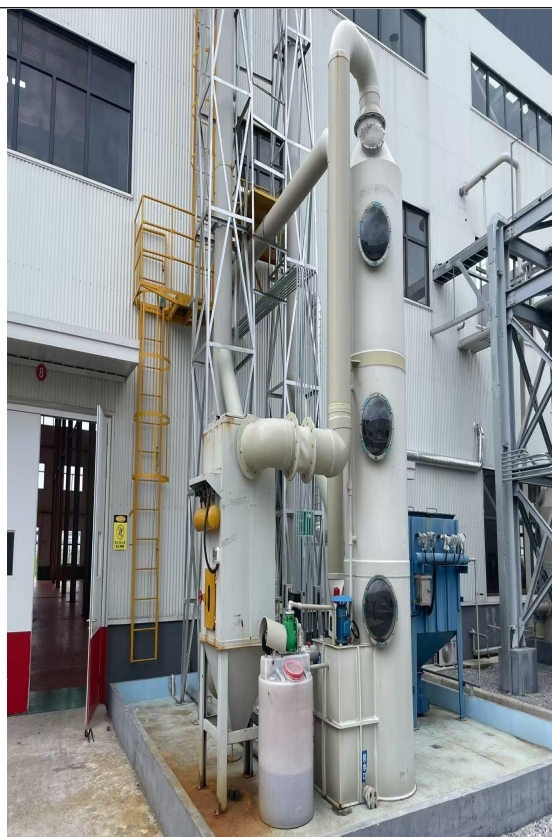
FQ-07 处理设施 (碱喷淋+布袋除尘)
