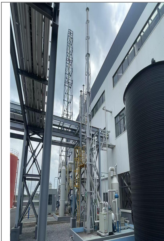
FQ-05 排气筒 15 米 (DA003)
