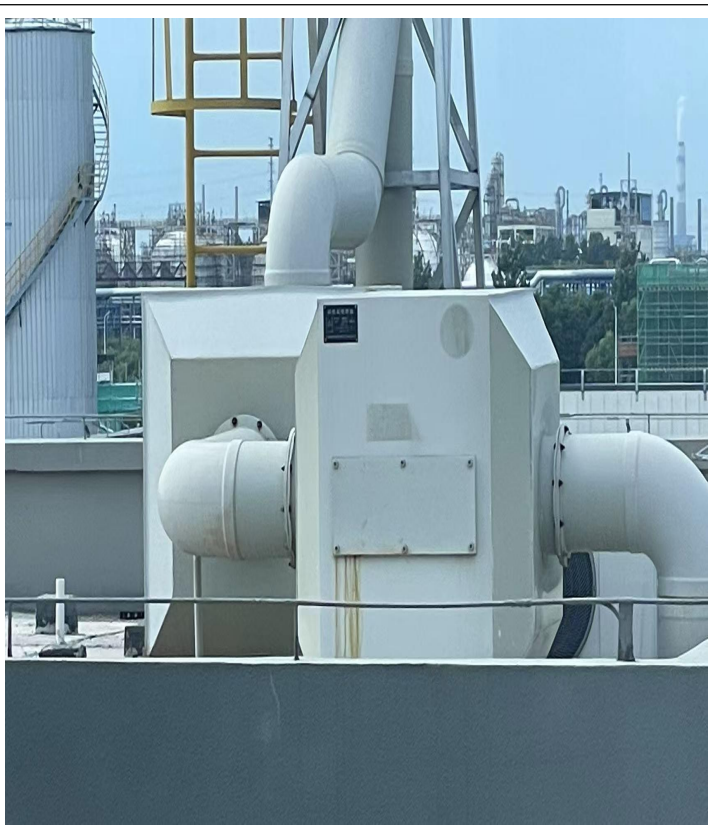
FQ-09 处理设施 (二级活性炭)
