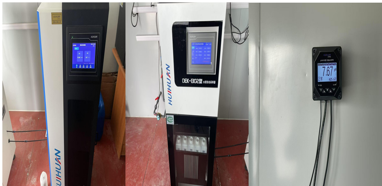
废水总排口在线监测水量、pH、COD、氨氮
