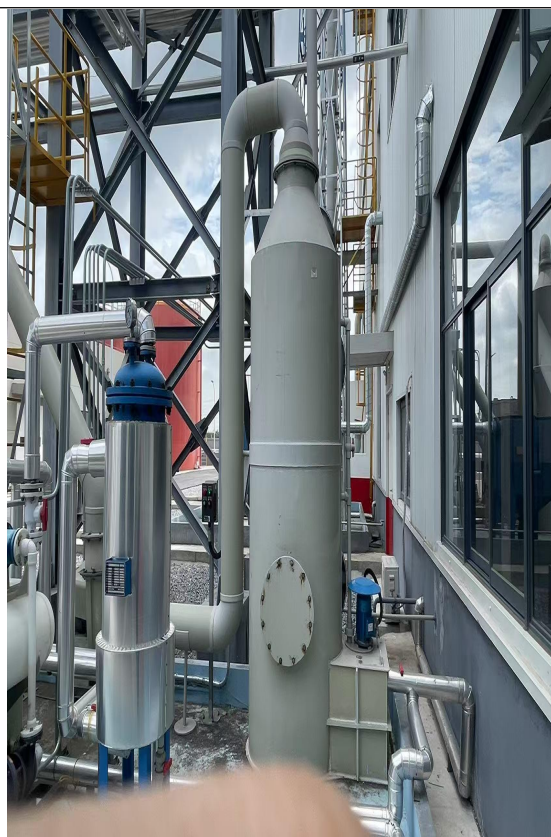
FQ-05 处理设施 (三级水洗塔)
