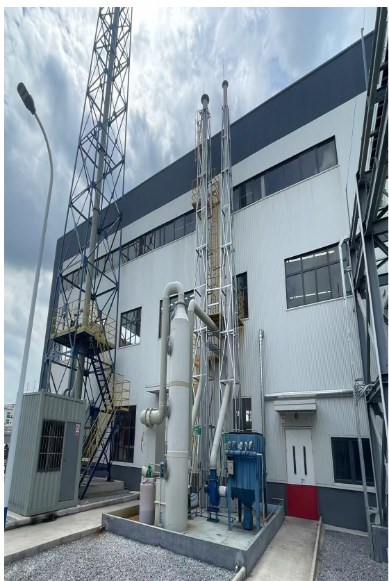
FQ-04 排气筒 15 米 (DA002)
