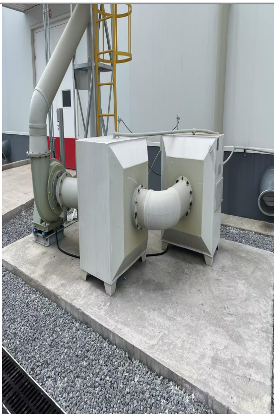
FQ-08 处理设施 (二级活性炭)
