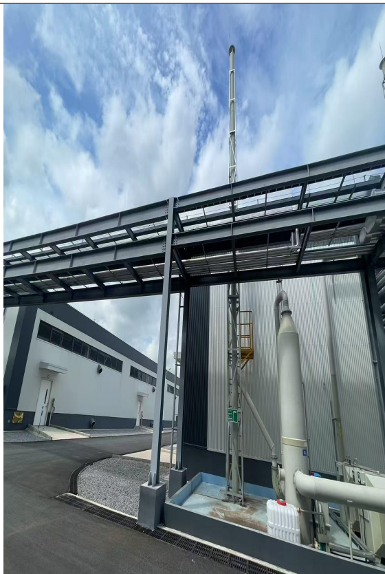
FQ-03 排气筒 15 米 (DA001)
