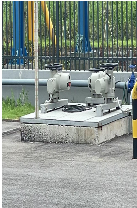
雨水排口照片
