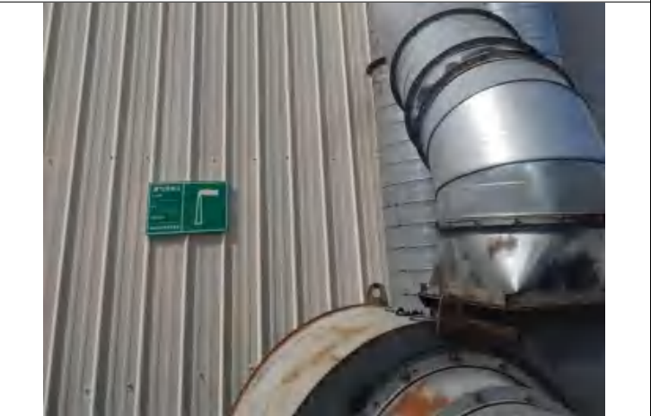
废气排放口环保标识牌
