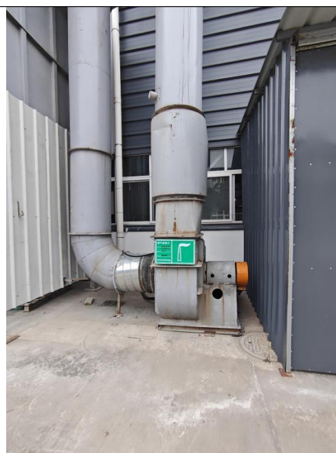
废气排放口标识牌-喷砂、喷铝除尘 DA014
