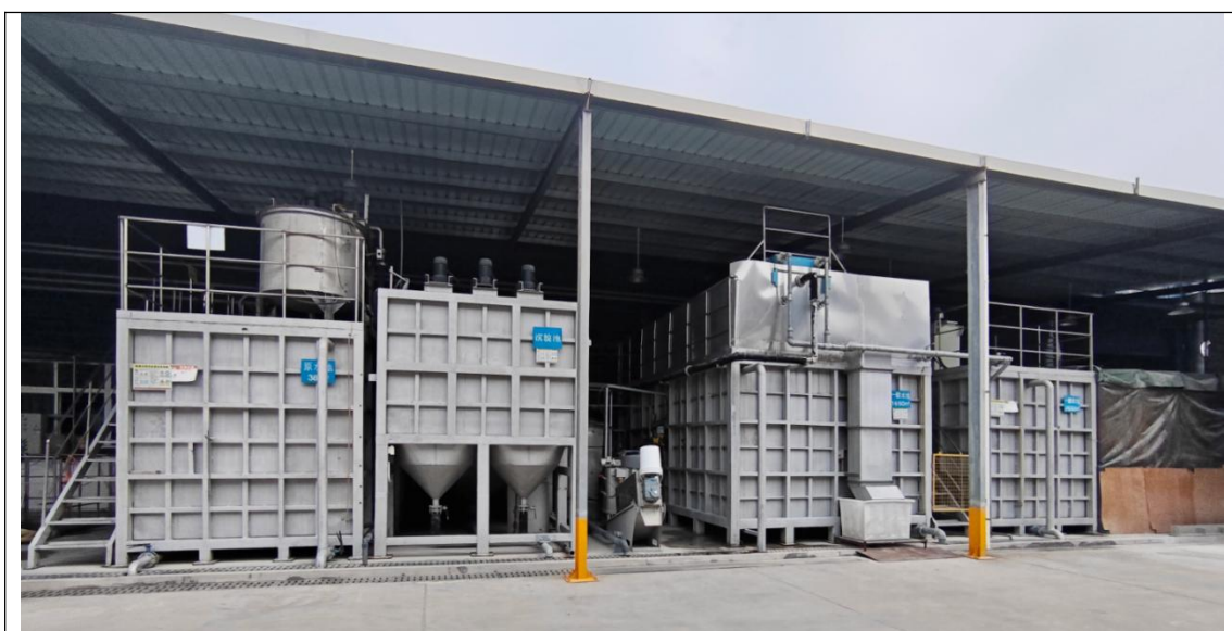
污水处理站照片
