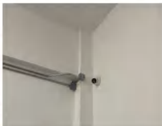
危废仓库外部监控装置
