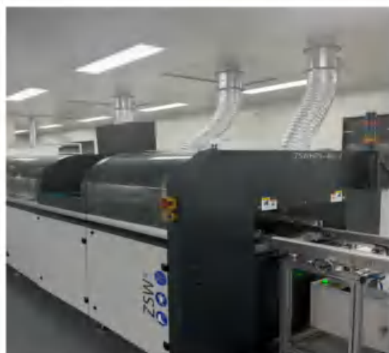
波峰焊接废气密闭收集情况
