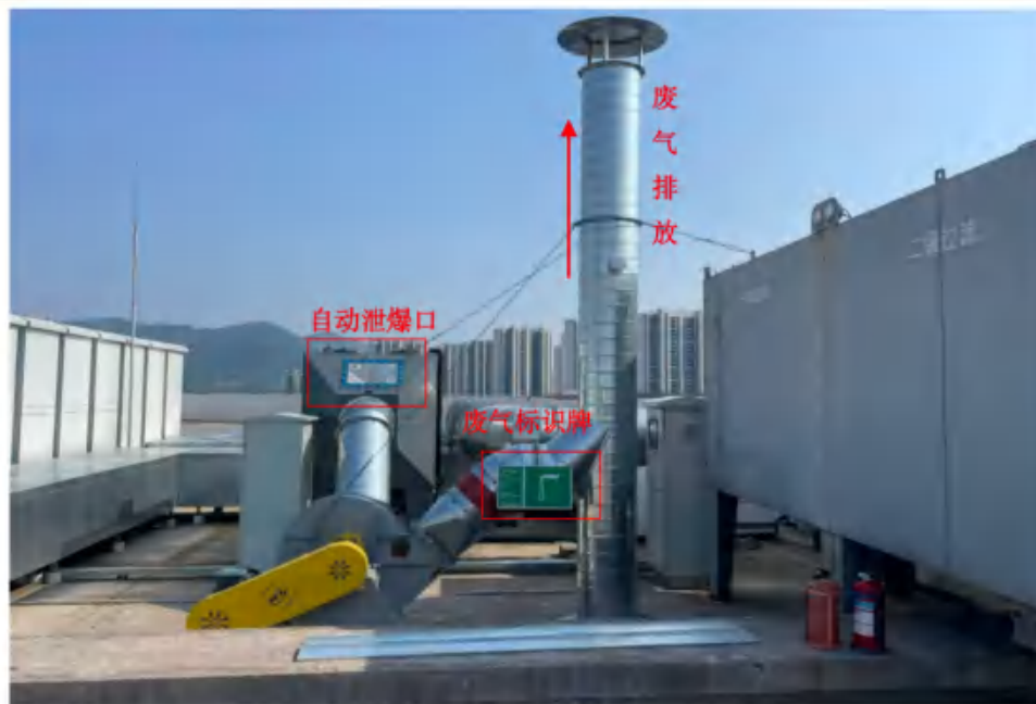
废气处理及排放现场情况
