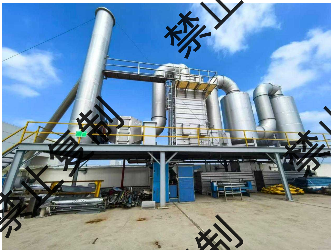
图 4-3 “水喷淋+静电除油”装置及配套排气筒出口
