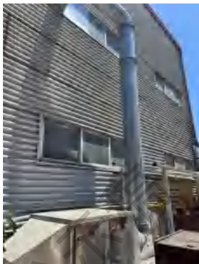
两级活性炭吸附装置（喷粉固化废气）
