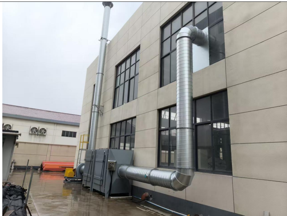
注塑挤出废气处理设施（1#排气筒）
