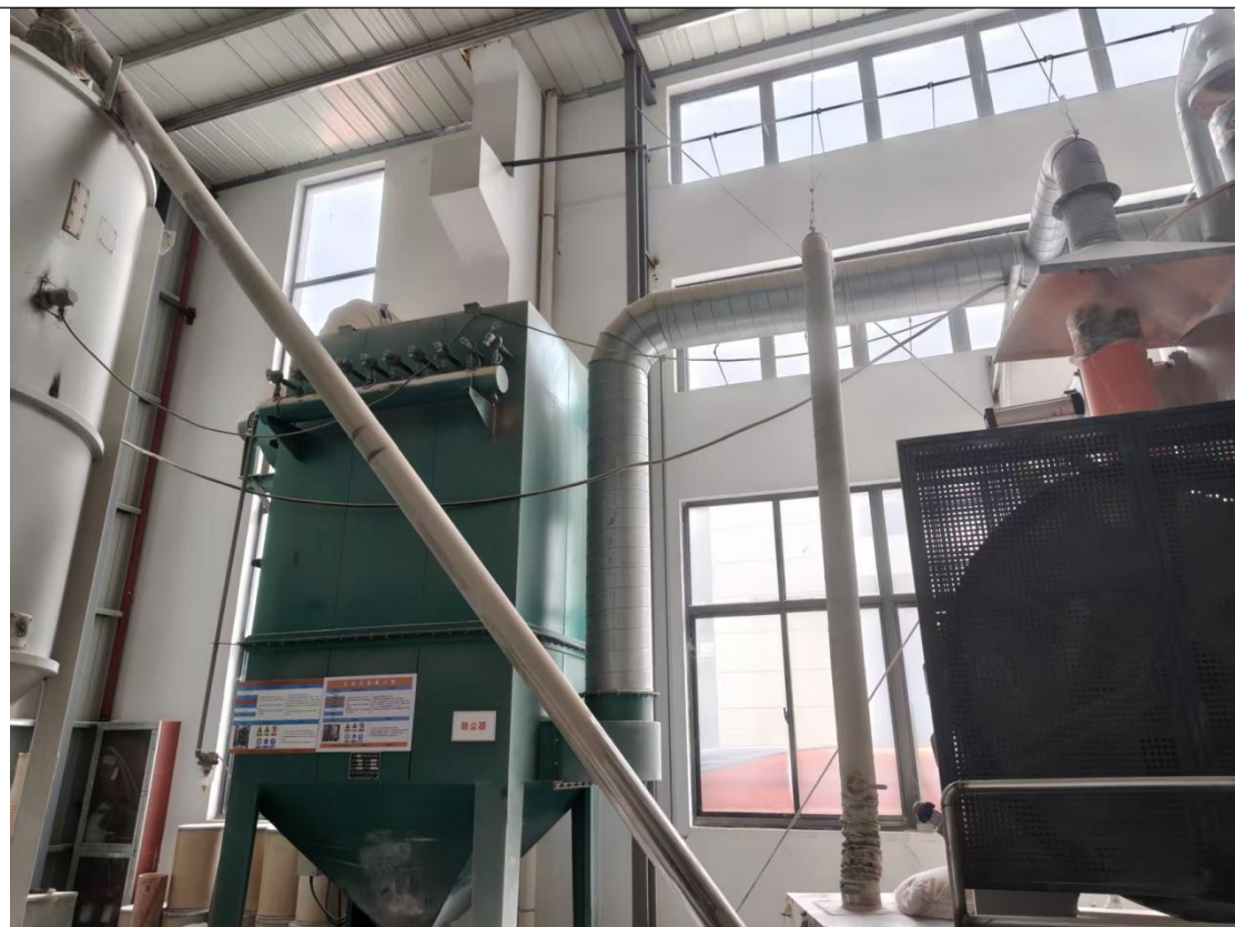
聚氯乙烯投料粉尘处理设施（2#排气筒）
