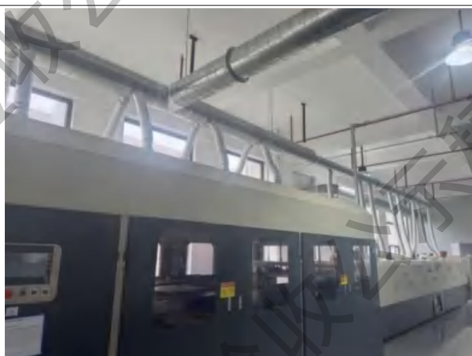
废气收集措施
