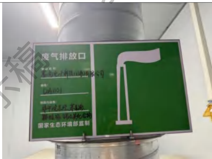
废气排放口 DA001 环保标识牌
